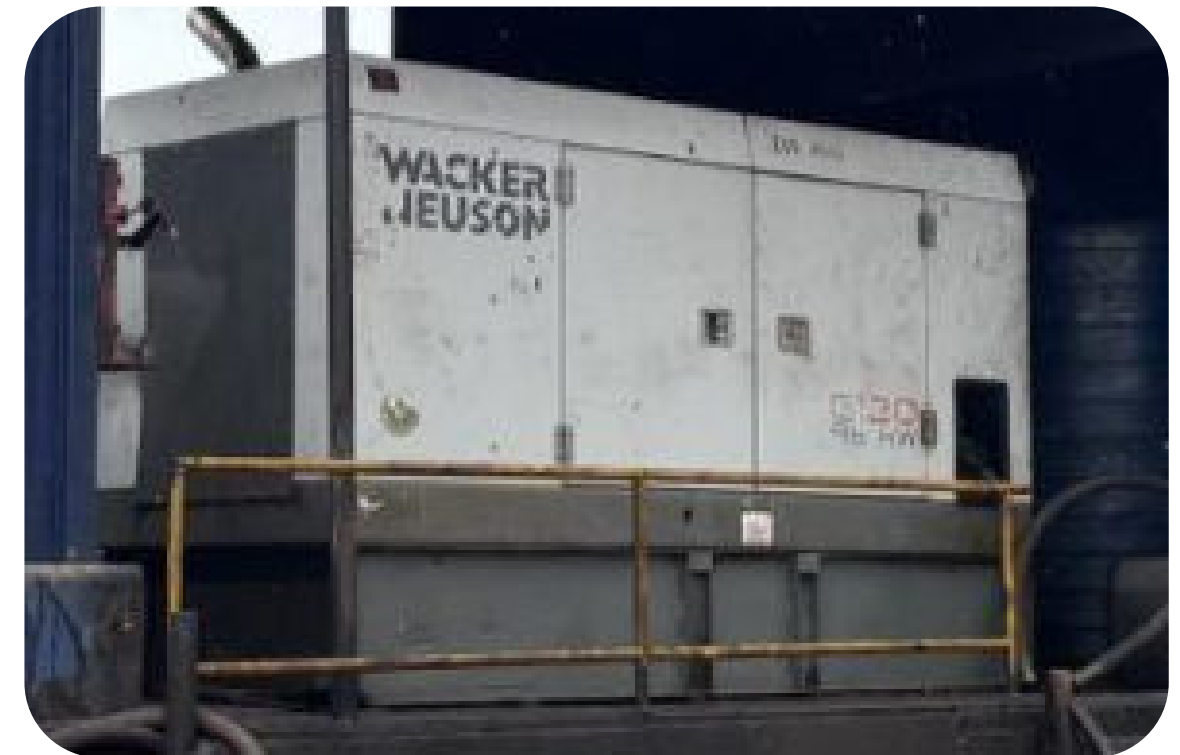
GENERADOR ELÉCTRICO WAKER NEUSON
