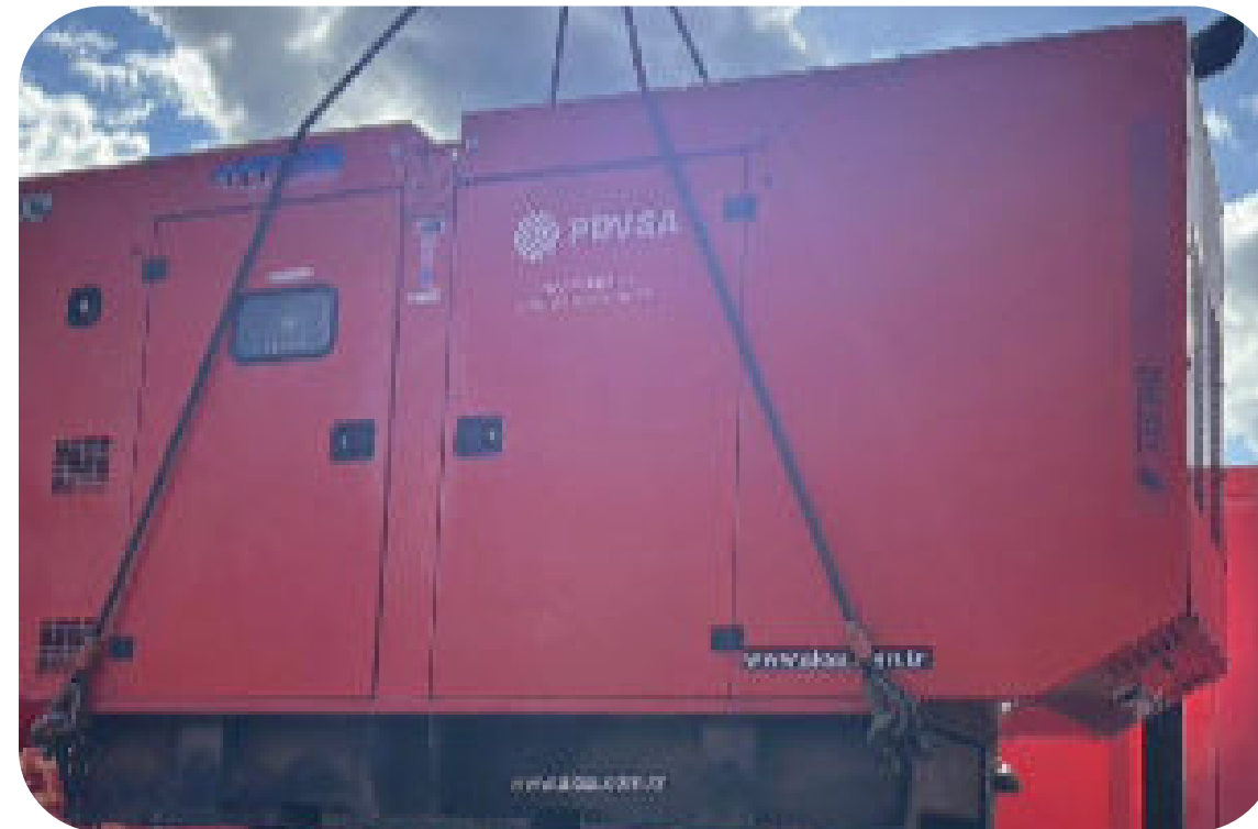
GENERADOR ELECTRICO PDV-TC-PE-15-1
