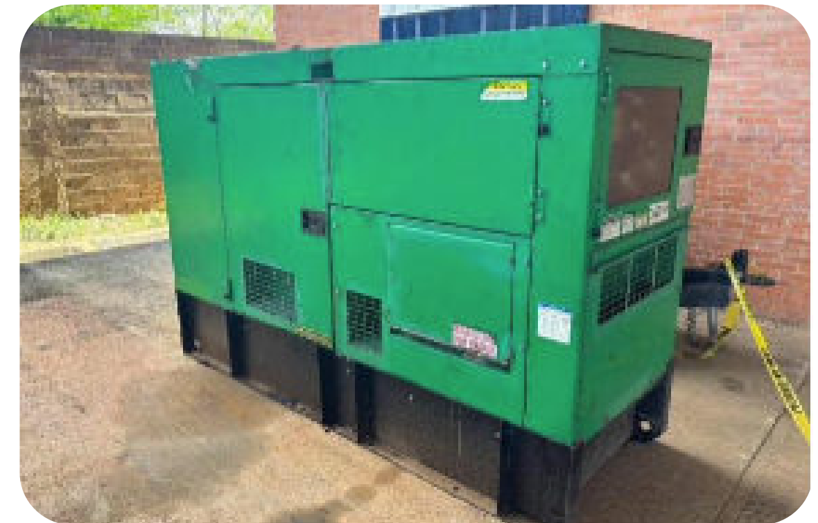
GENERADOR ELÉCTRICO JOHN DEERE DH-0750J
