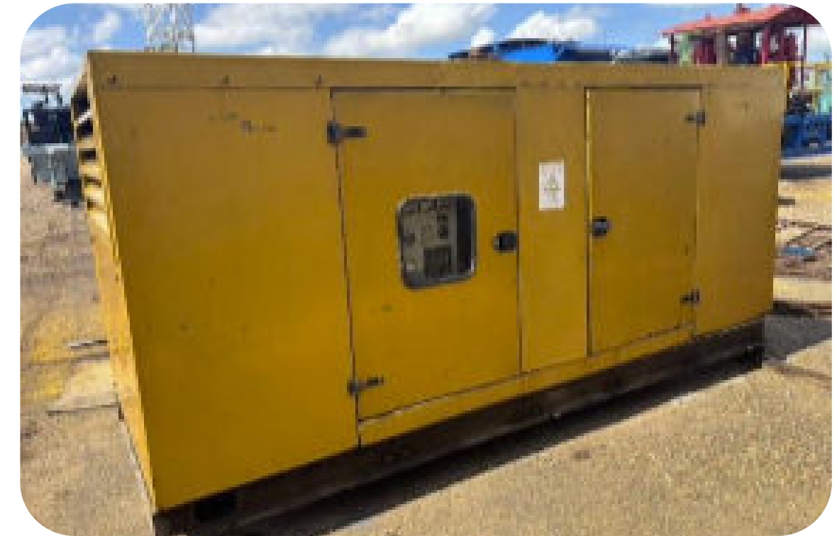
GENERADOR ELÉCTRICO STAMFORD CZ 160
