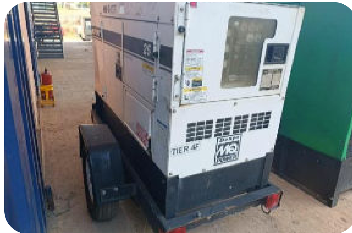
GENERADOR ELÉCTRICO MQ POWER
