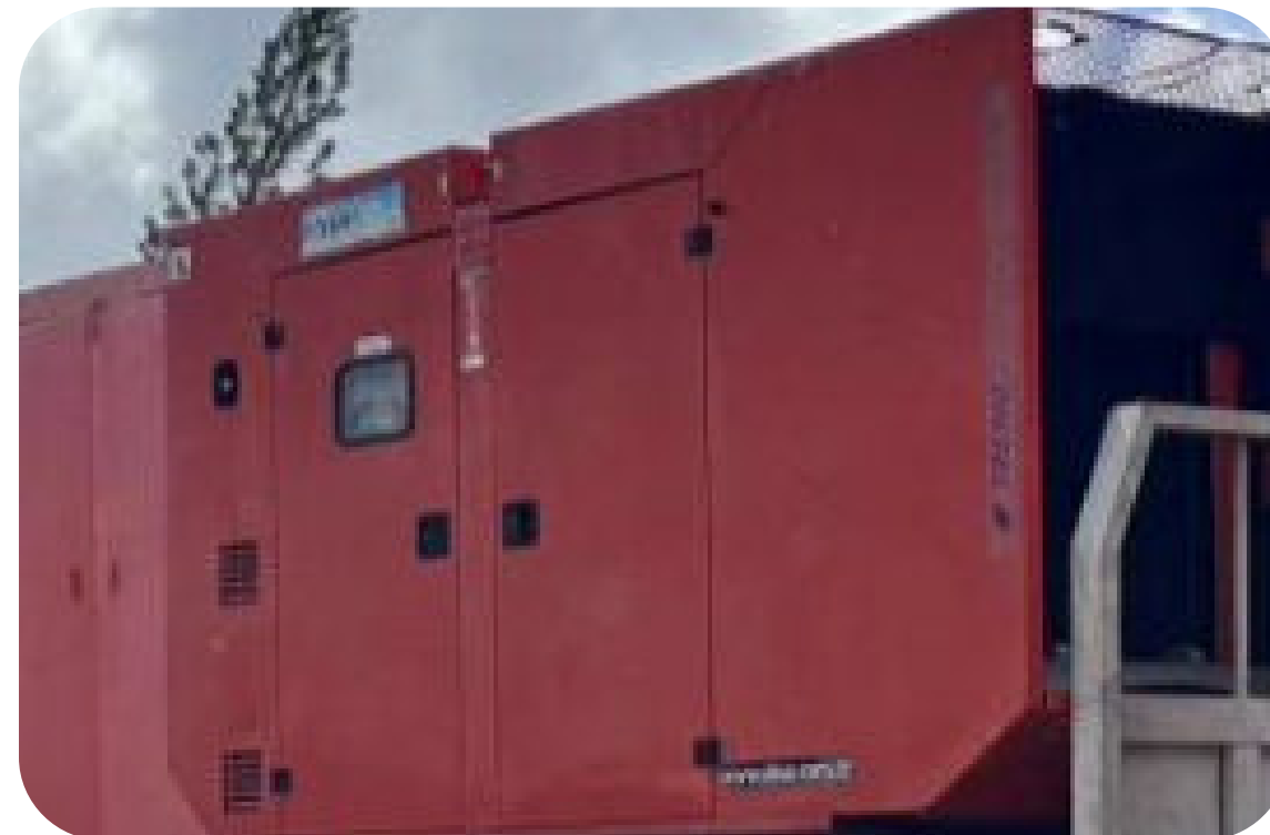
GENERADOR ELECTRICO PDV-TC-PE-15-2
