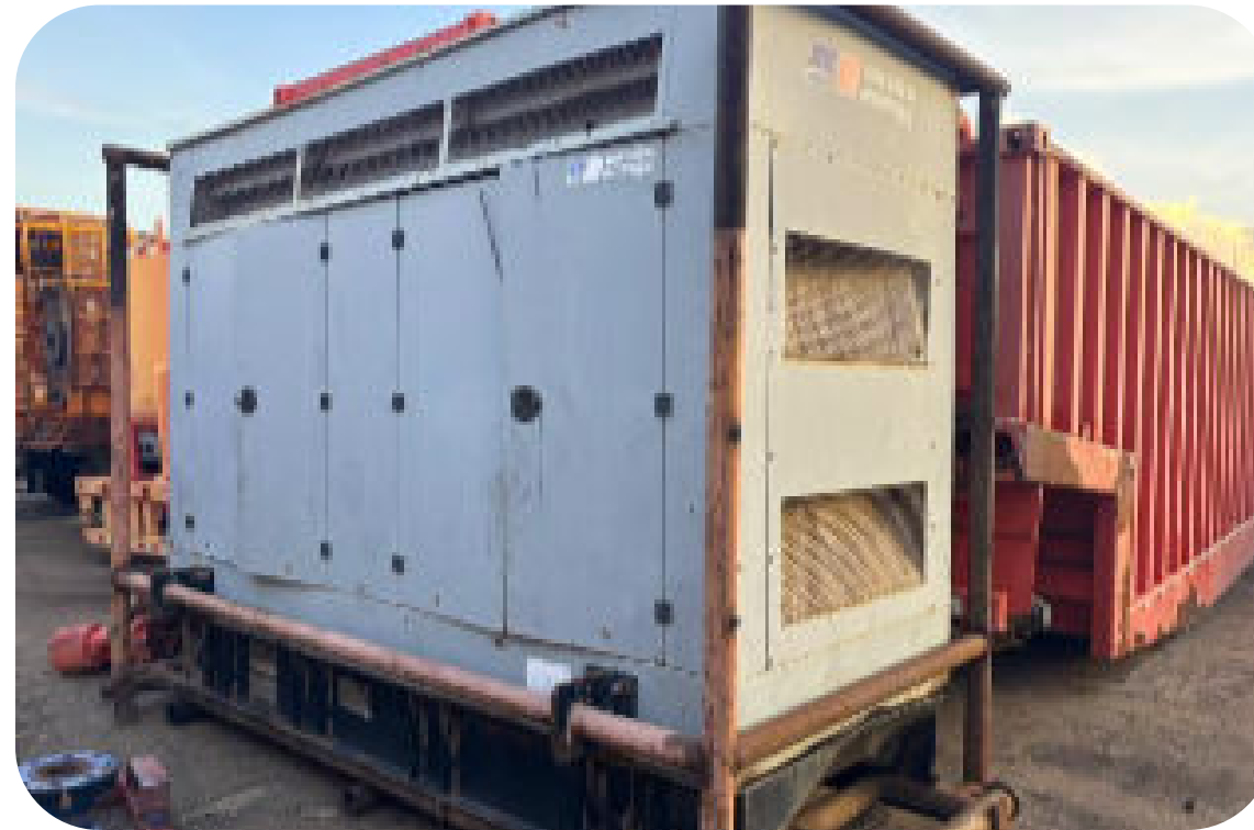
GENERADOR ELÉCTRICO PDV-60
