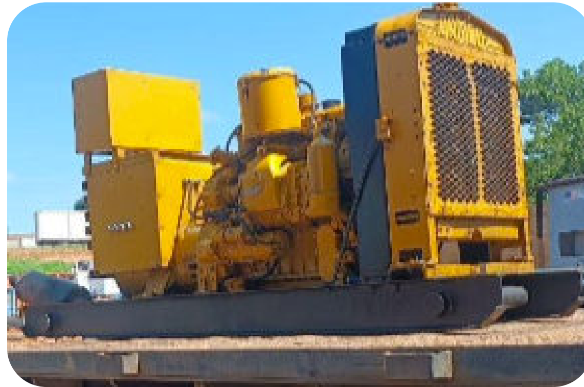
GENERADOR ELÉCTRICO DETROIT
