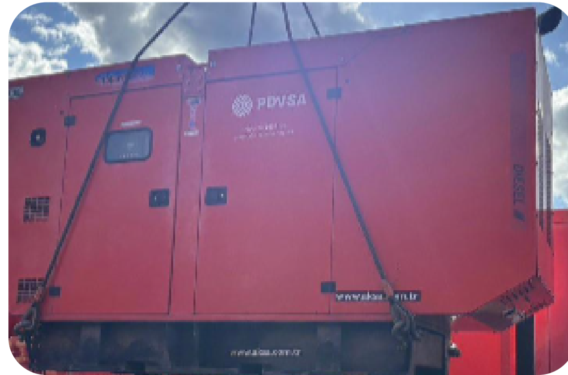
GENERADOR ELECTRICO PDV-TC-PE-15-1
