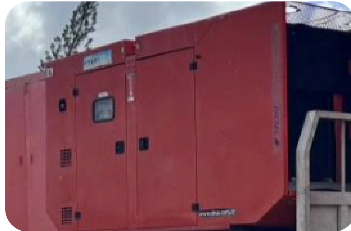
GENERADOR ELECTRICO PDV-TC-PE-15-2
