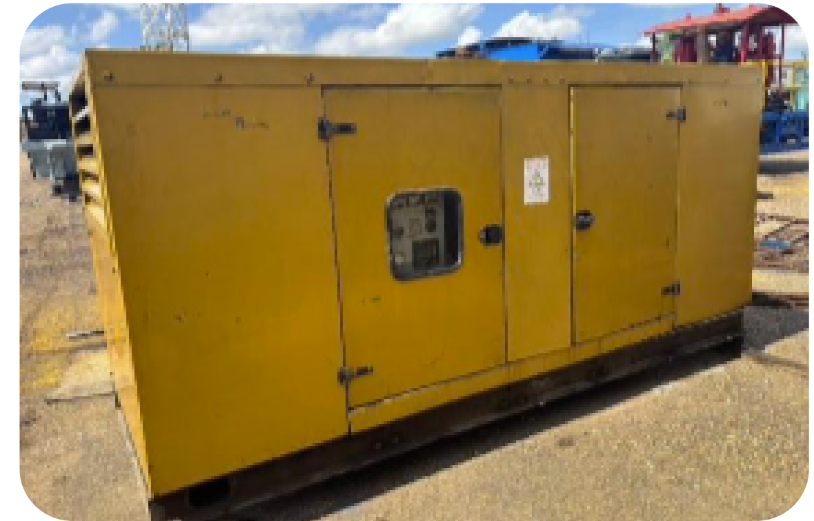
GENERADOR ELÉCTRICO STAMFORD CZ 160
