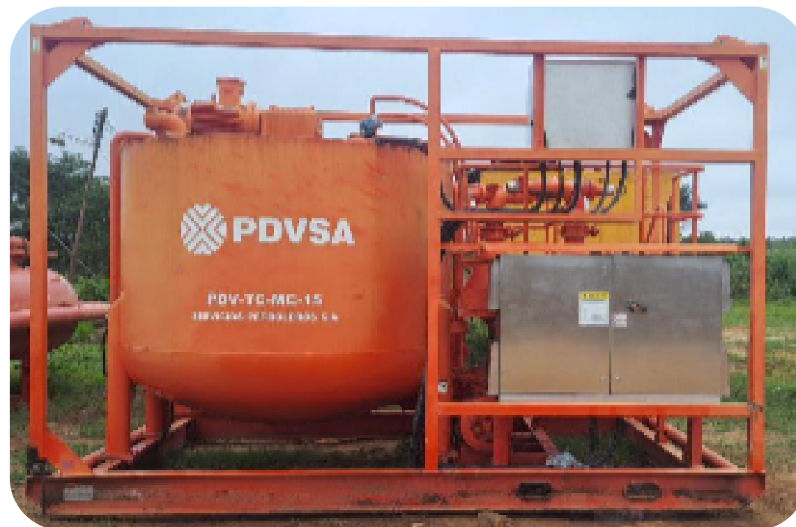
TANQUE CON MIXER PDV-TC-MC-15
