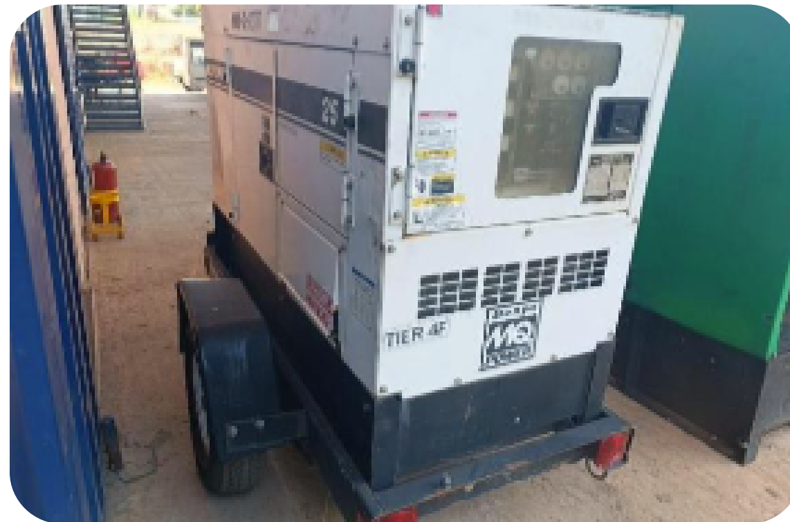
GENERADOR ELÉCTRICO MQ POWER
