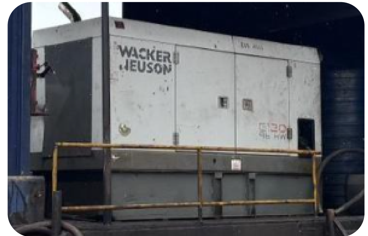
GENERADOR ELÉCTRICO WACKER NEUSON
