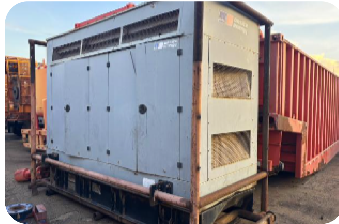
GENERADOR ELÉCTRICO PDV-60
