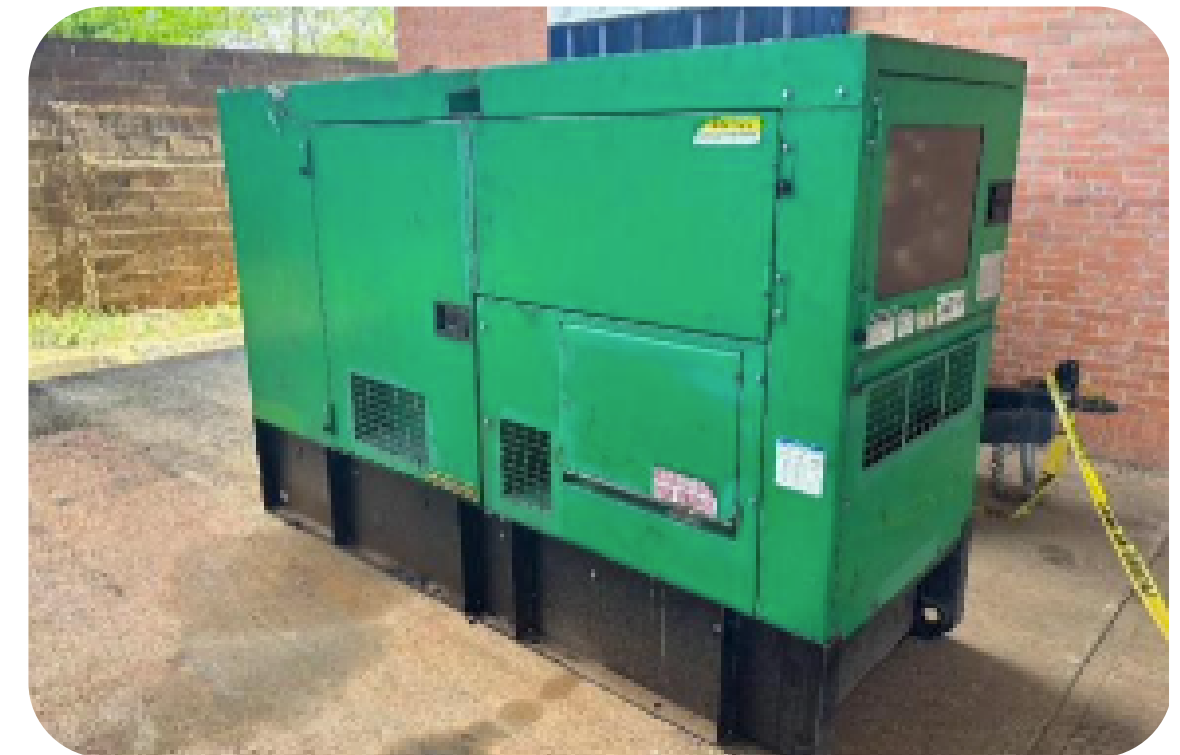
GENERADOR ELÉCTRICO JOHN DEERE DH-0750J
