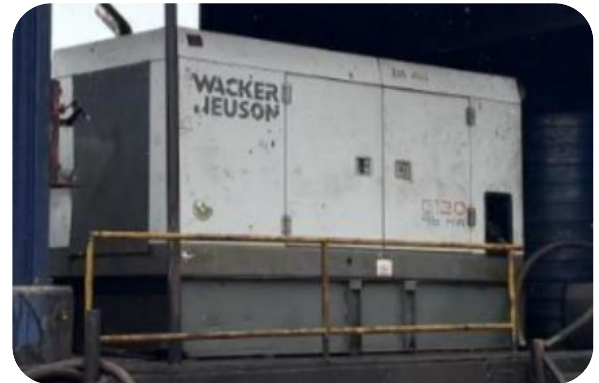
GENERADOR ELÉCTRICO WACKER NEUSON
