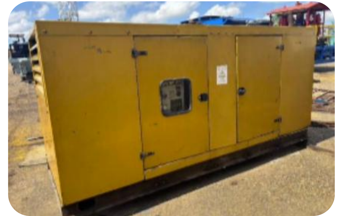
GENERADOR ELÉCTRICO STAMFORD CZ 160
