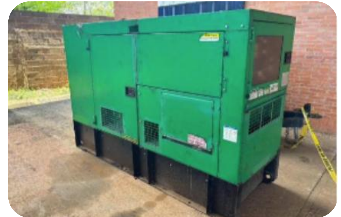
GENERADOR ELÉCTRICO JOHN DEERE DH-0750J
