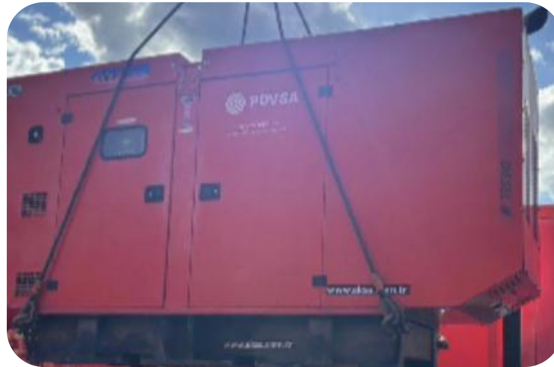
GENERADOR ELECTRICO PDV-TC-PE-15-1
