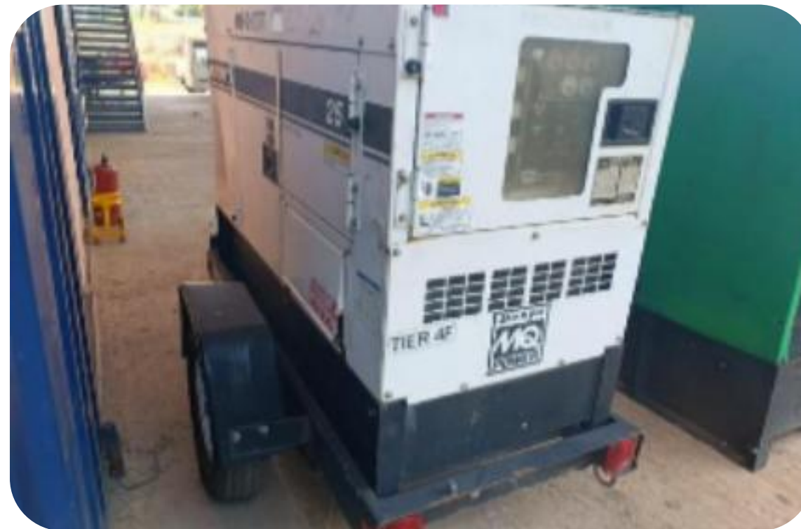
GENERADOR ELÉCTRICO MQ POWER
