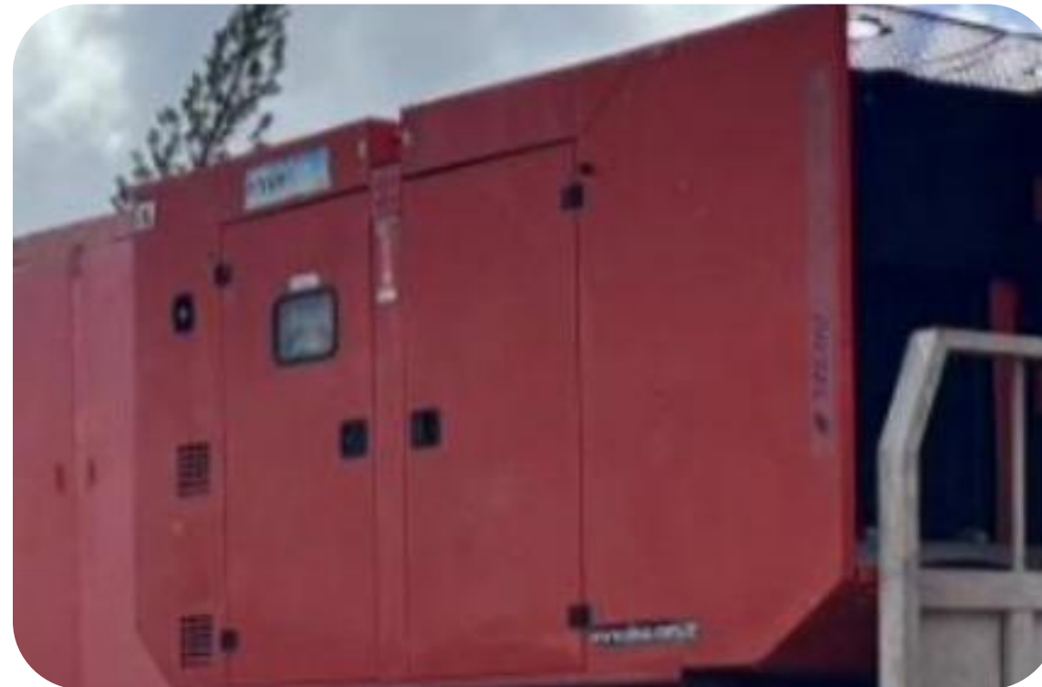
GENERADOR ELECTRICO PDV-TC-PE-15-2
