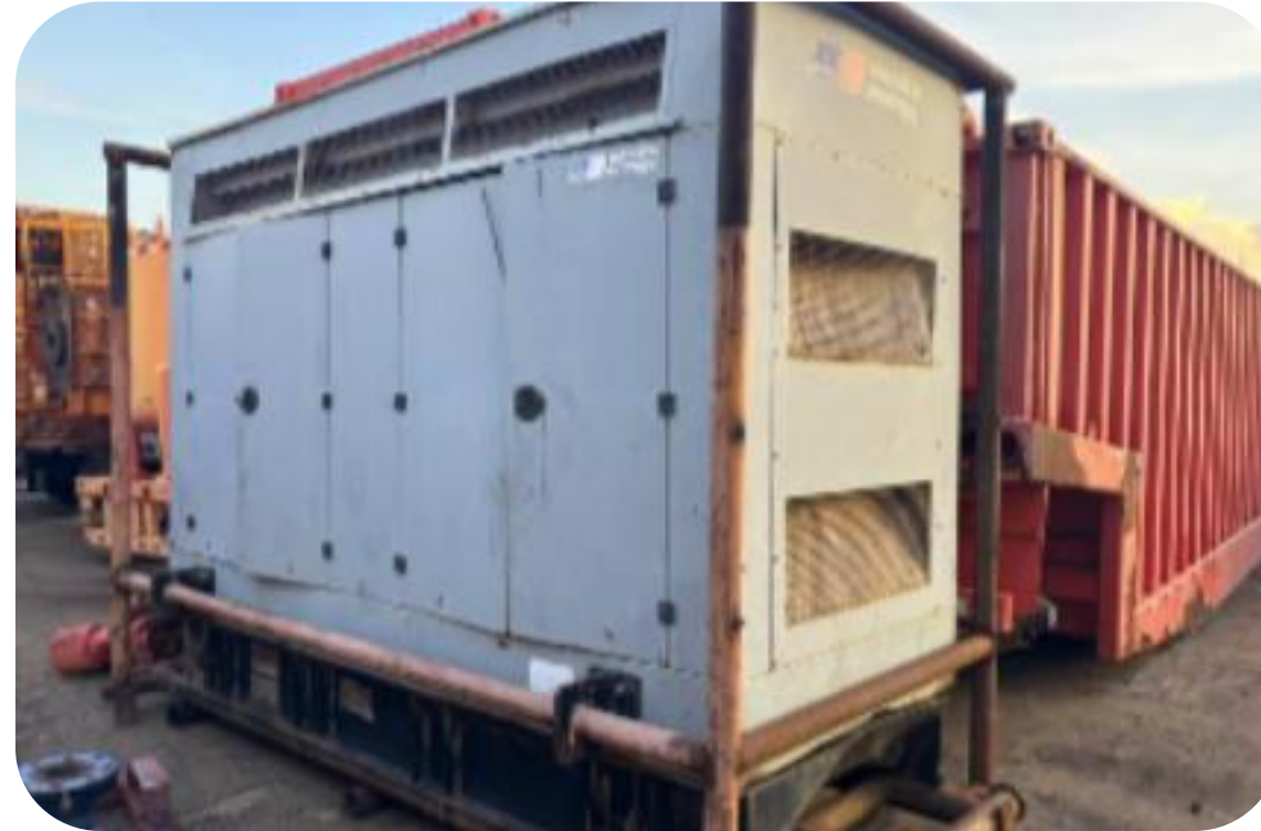
GENERADOR ELÉCTRICO PDV-60
